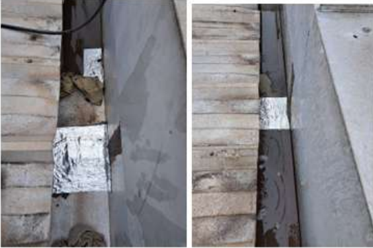
Aplicación de sello en canaletas de techos por filtraciones en salas de clase
